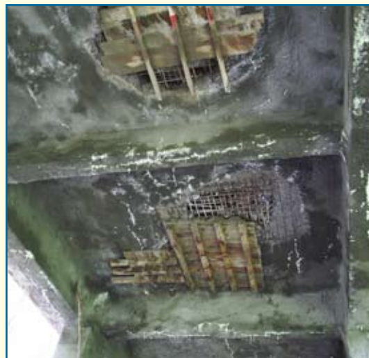
Most Pčinja prije sanacije
