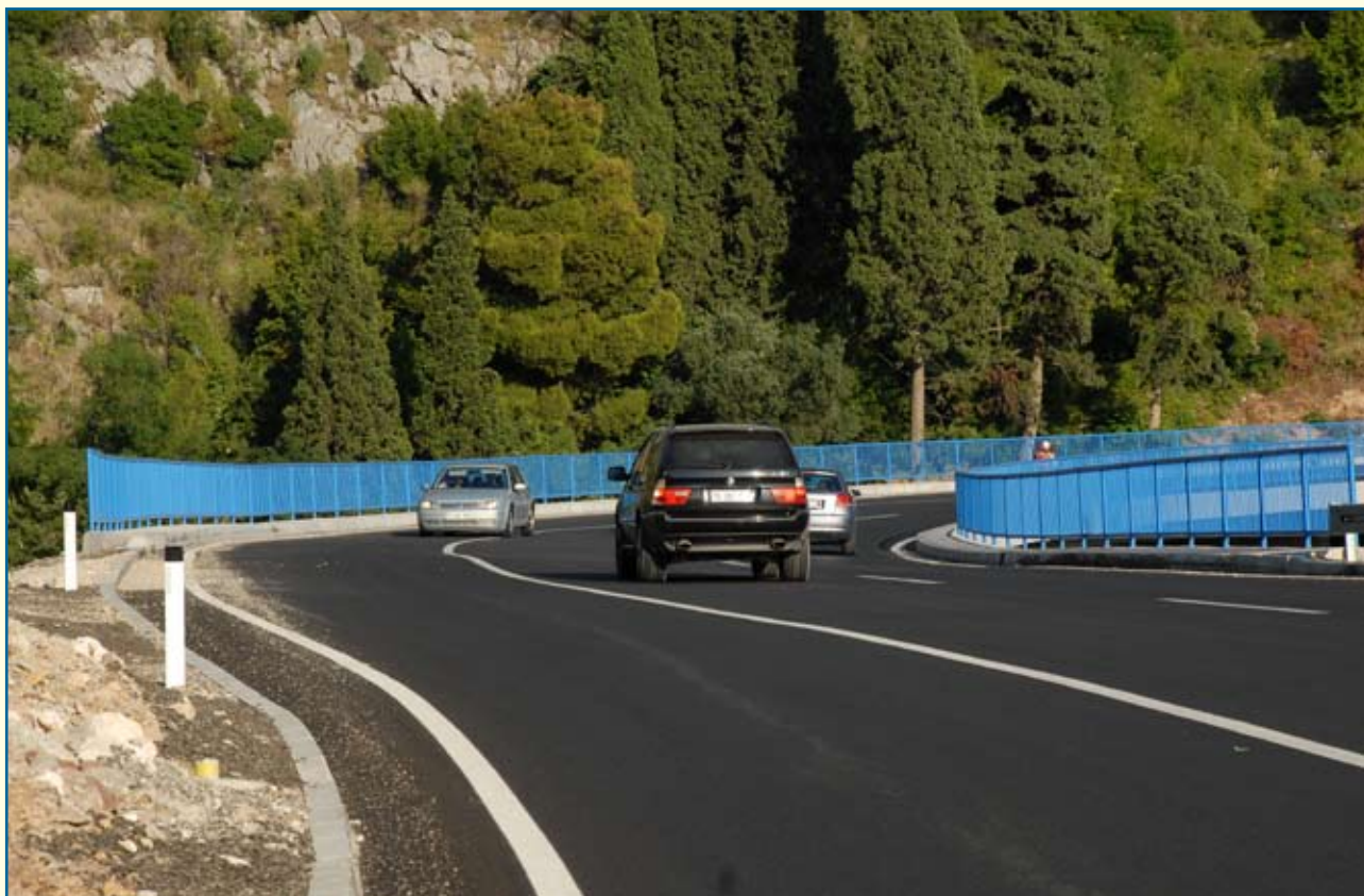
Most na lokalitetu Kufin, na putu Bar Petrovac, u toku sanacije, Program rješavanja uskih grla, 2007 – 2009. god
