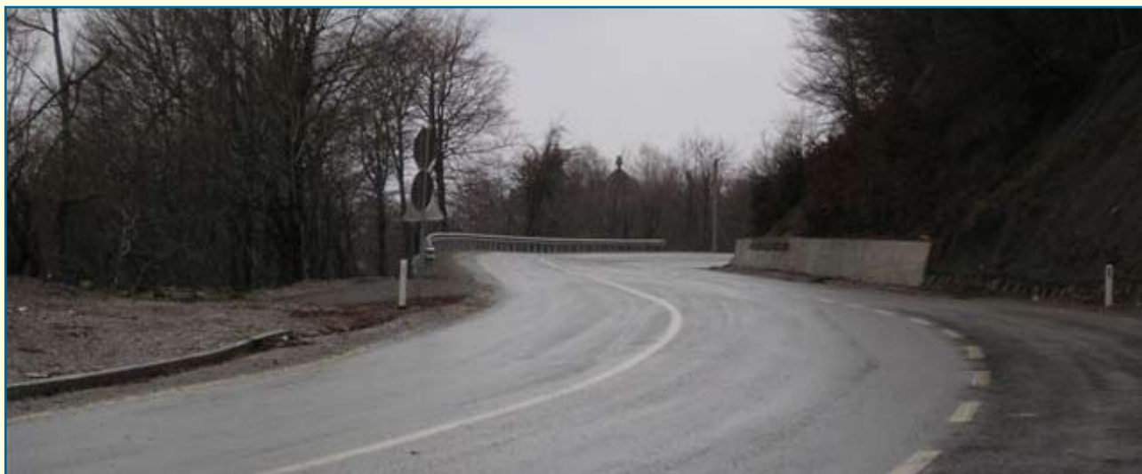
Lokalitet Crkvine (990 m) na putu Podgorica Kolašin, Izvršena sanacija klizišta i izgradnja treće trake, Program saniranja kritičnih tačaka, 2005 - 2007.
