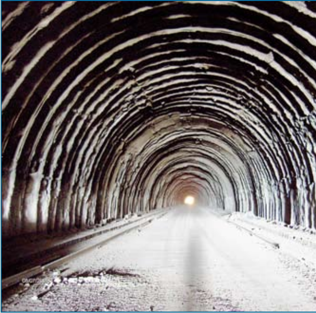
Tunel Vrmac na putu na ulazu u Kotor prije sanacije
