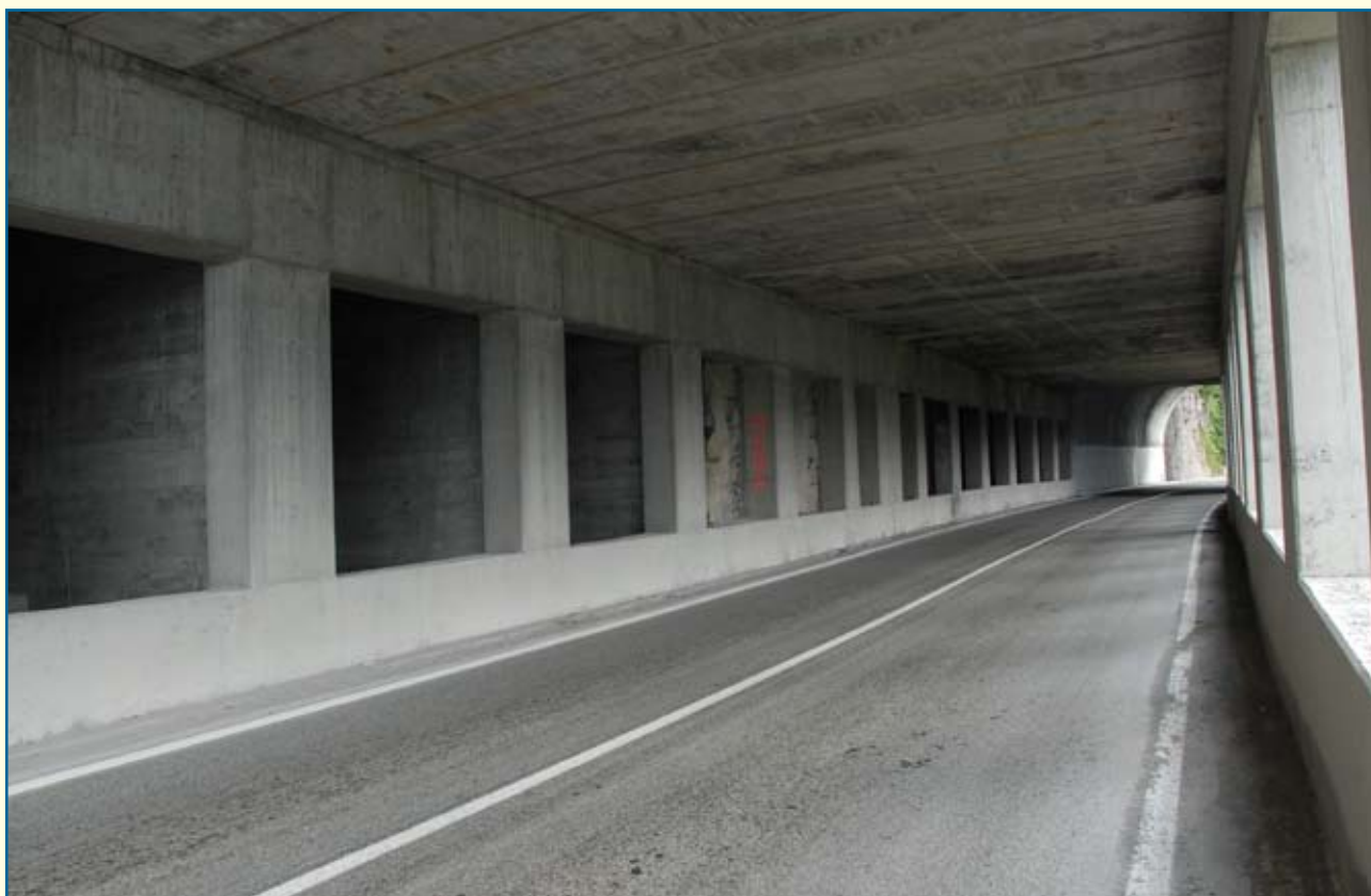
Bakovića klisura, na putu Podgorica Kolašin nakon izrade zaštitne galerije, Program saniranja kritičnih tačaka, 2005 – 2007. god.
