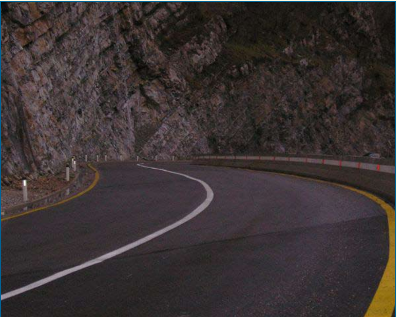
Dionica Subadanj (550 m), na putu Podgorica Kolašin, rekonstrukcija puta, Program saniranja kritičnih tačaka, 2005 - 2007. god.
