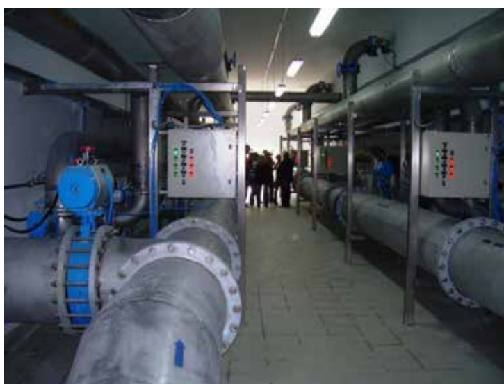
Slika 1.19/6 Filterska stanica Mojdež, cijevna galerija
