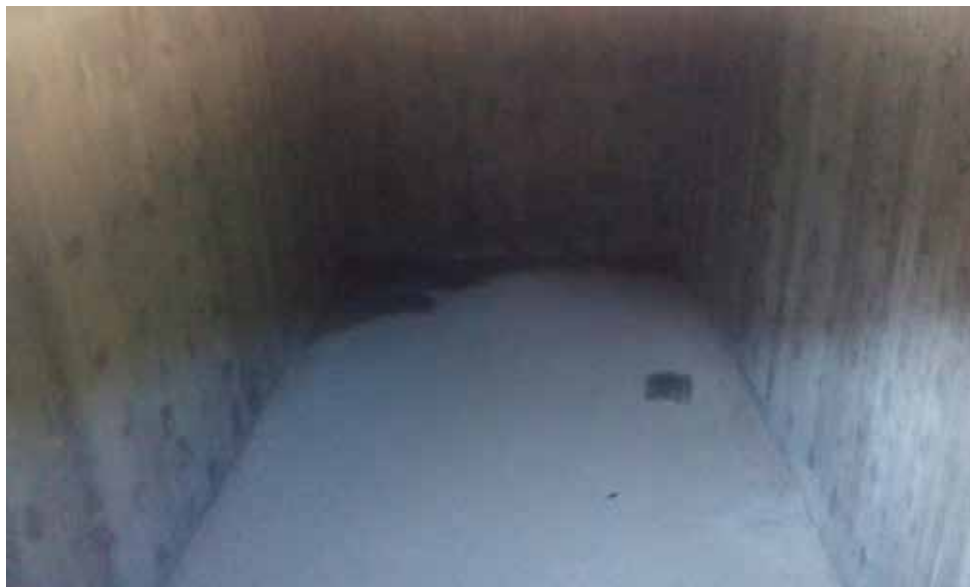
Slika 1.1/6 Rezervoar kod hlorinatorske stanice
