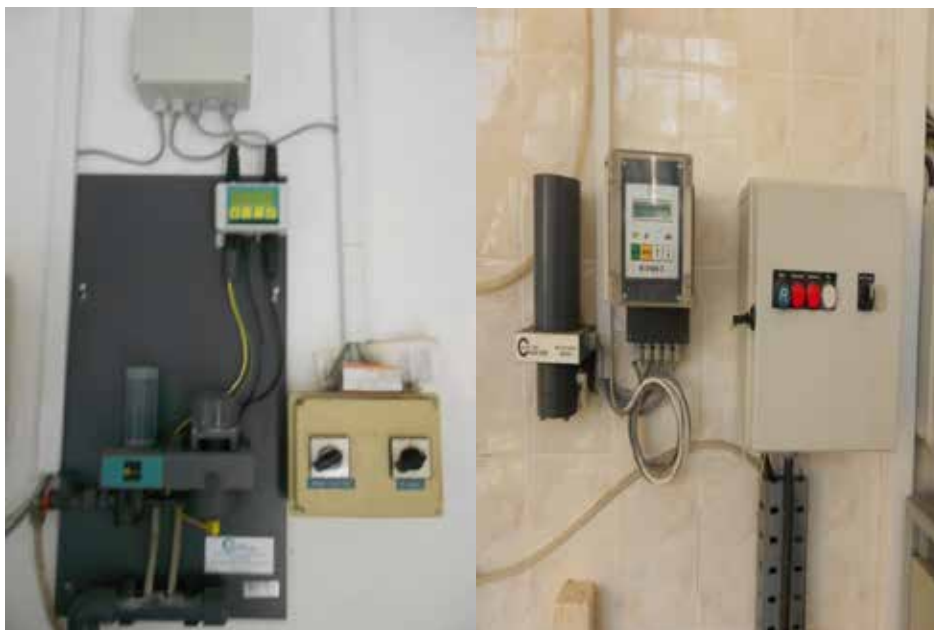
Slika 1.2/13 Hlorna stanica na izvorištu Brca
