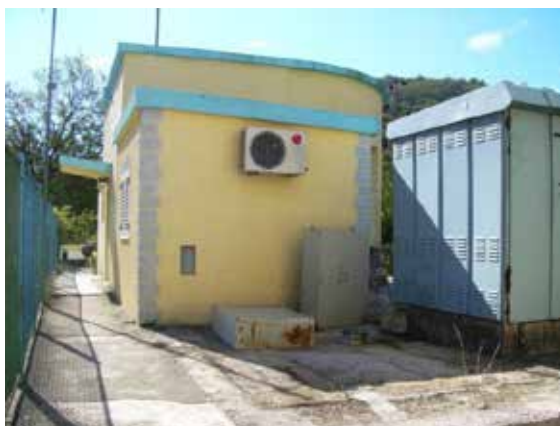
Slika 1.19/8 Pumpna stanica Opačica
