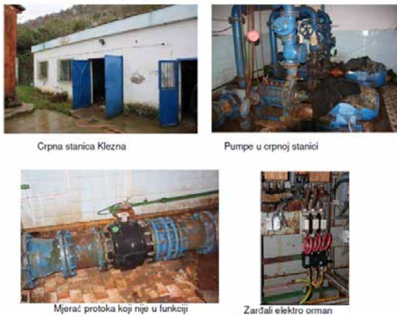
Slika 1.18/7 Crpna stanica Klezna
