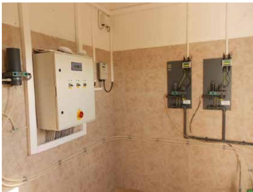
Slika 1.2/12 Hlorna stanica na izvorištu Spile
