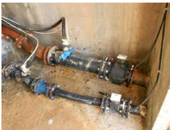
Slika 1.2/18 Mjerači protoka na rezervoaru Spile
