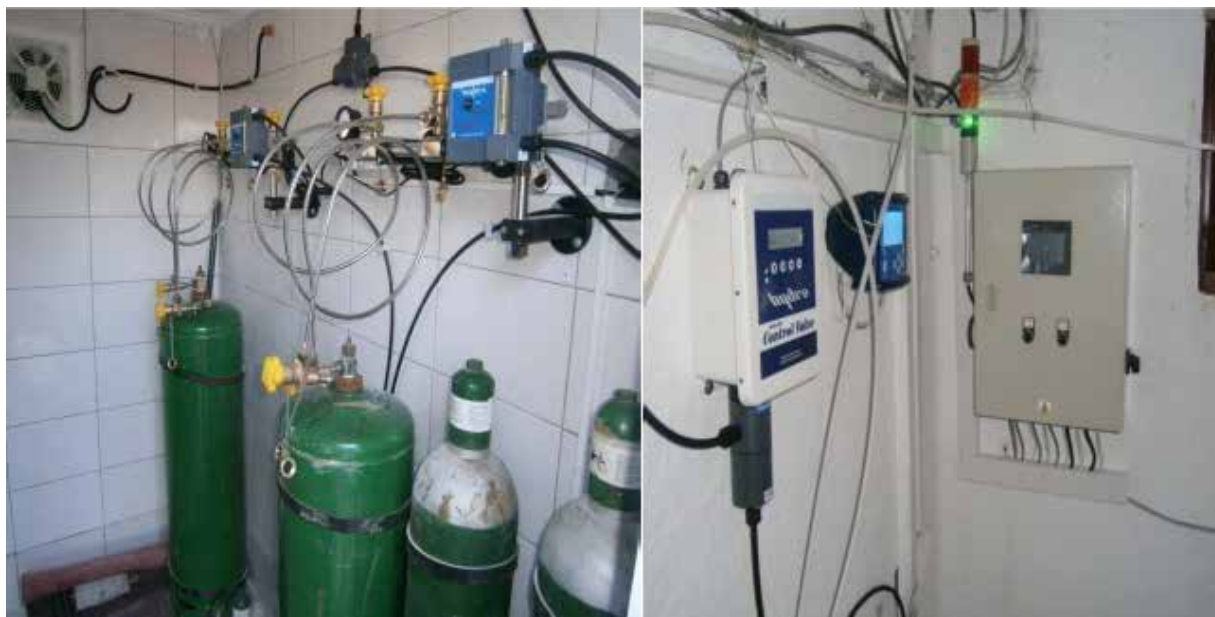
Slika 1.20/11 Automatska hlorna stanica PK "Lašor"
