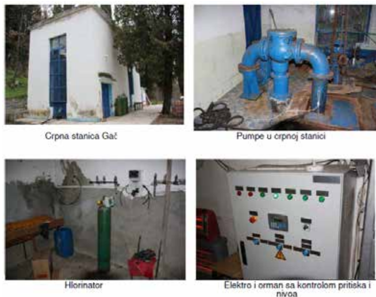
Slika 1.18/8 Crpna stanica Gač
