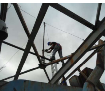
Slika 12 Silos za glinicu
