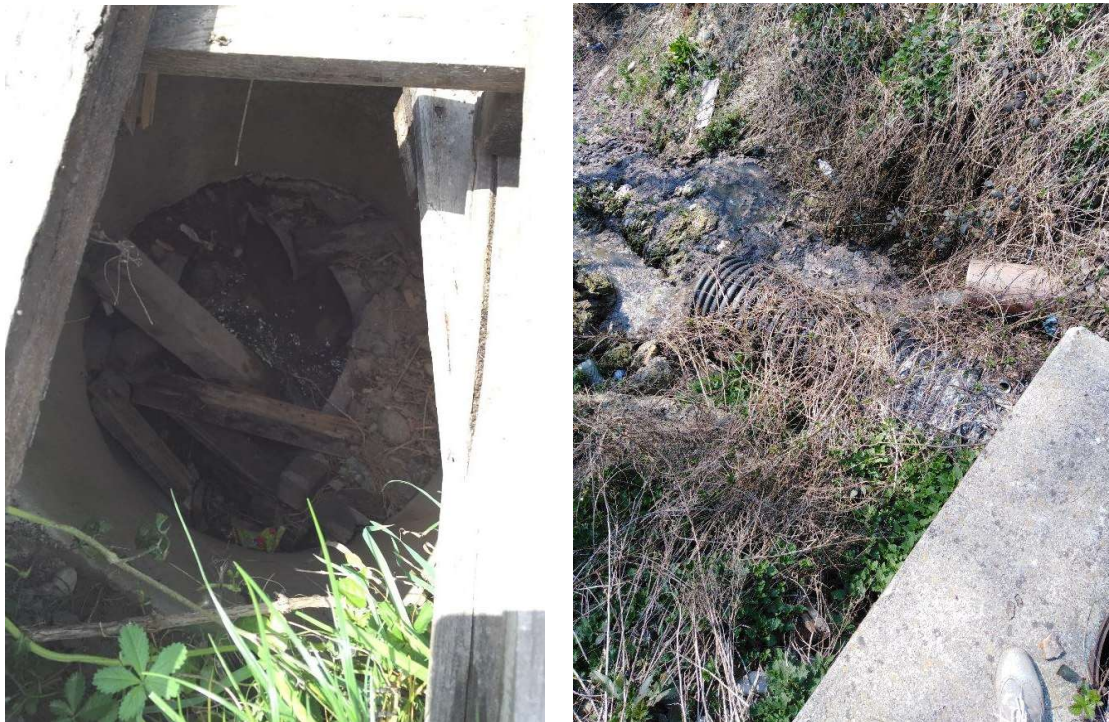
(postojeći ispust kod zgrade Petoljetke)
