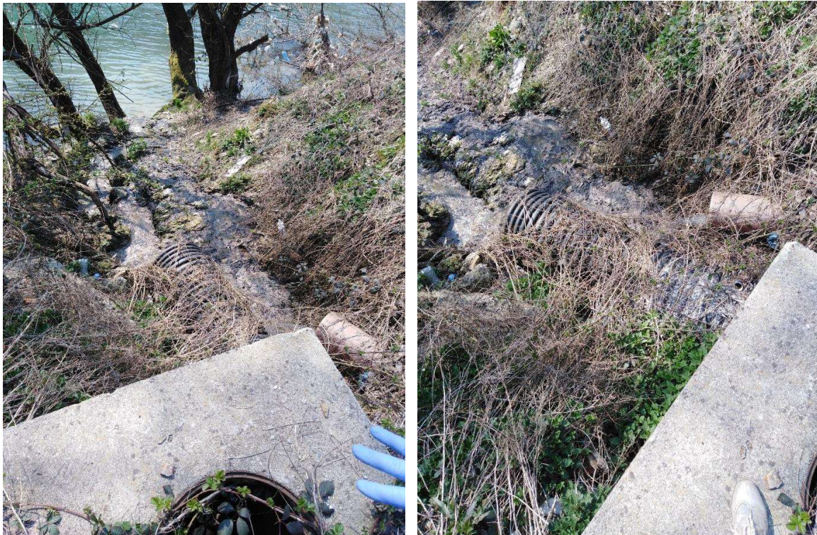
(postojeći glavni gradski kolektor)
