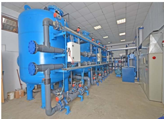
Primer filterskog postrojenja sa brzim peščanim filterima
