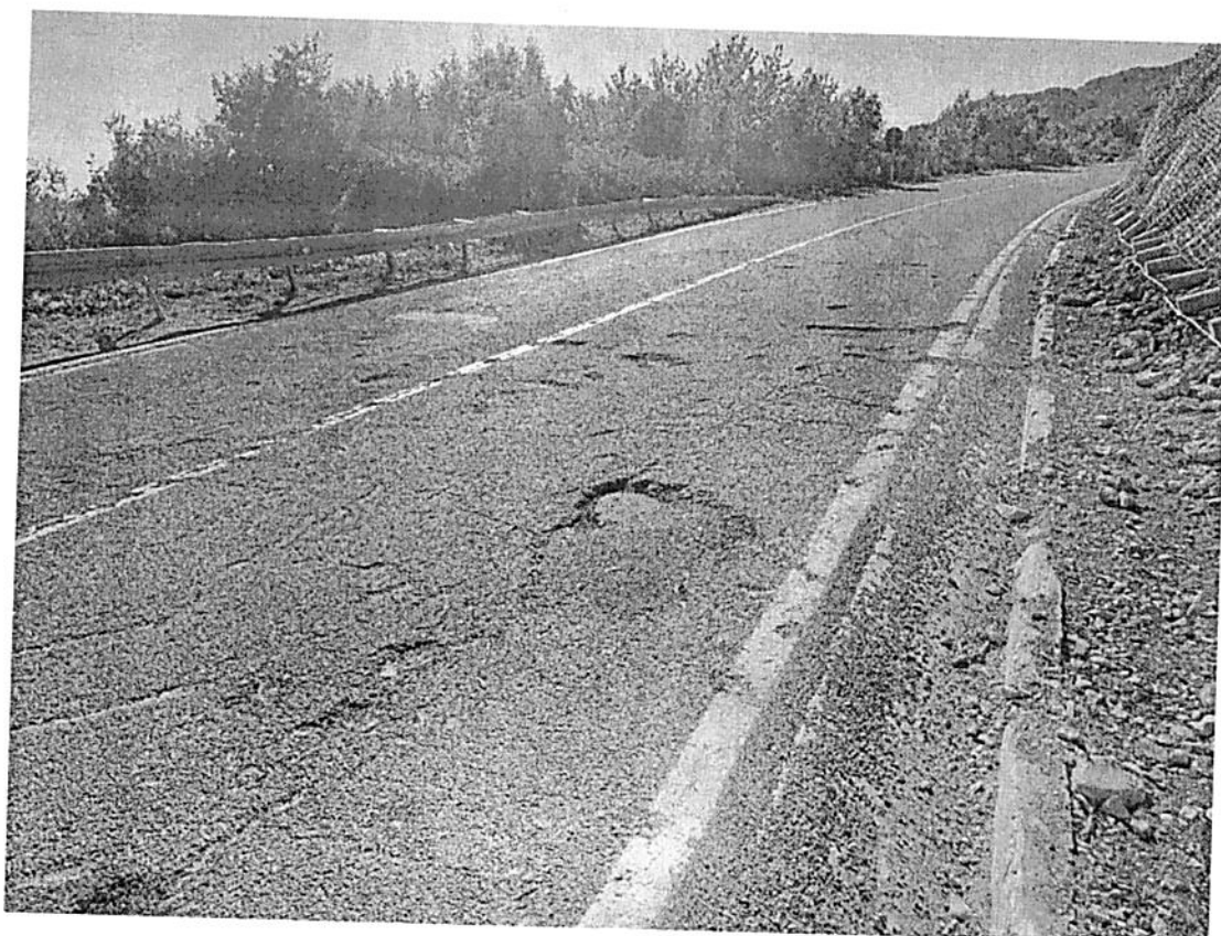
Uslijed odrona stijenskih blokova deformisan kolovoz puta, građevinski elementi puta i deformisana odbojna ograda (23.09.2025. godine)
