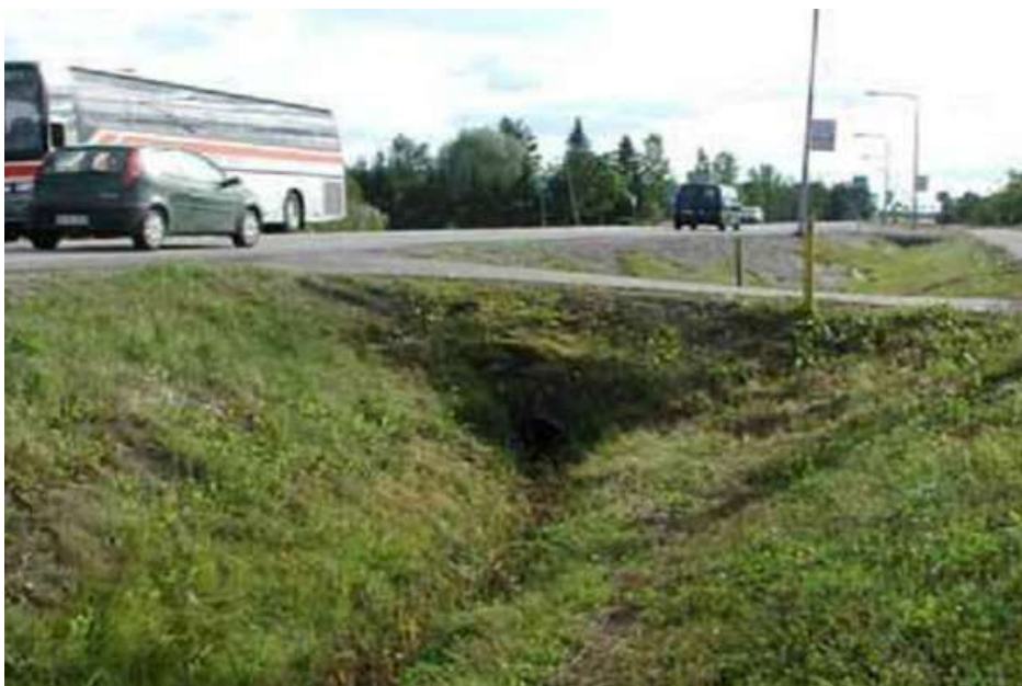
Slika II-18: Nezaštićena odvodna cijev/nezaštićeni propust
