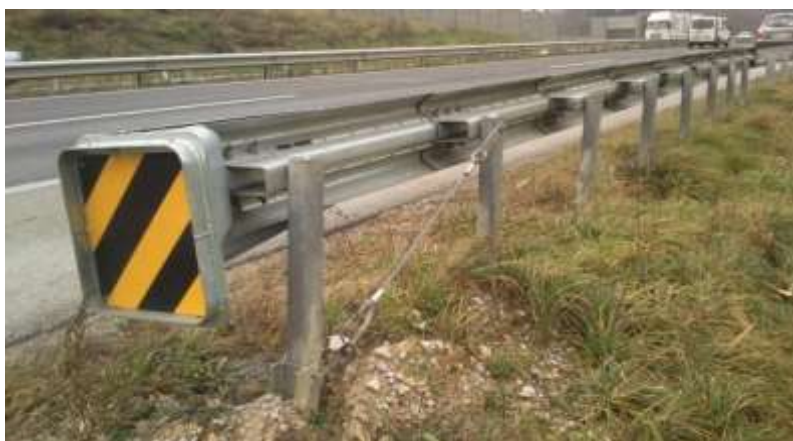
Slika I-37: Ublaživač sudara na početku zaštitne ograde (Izvor: T. Tollazzi)
