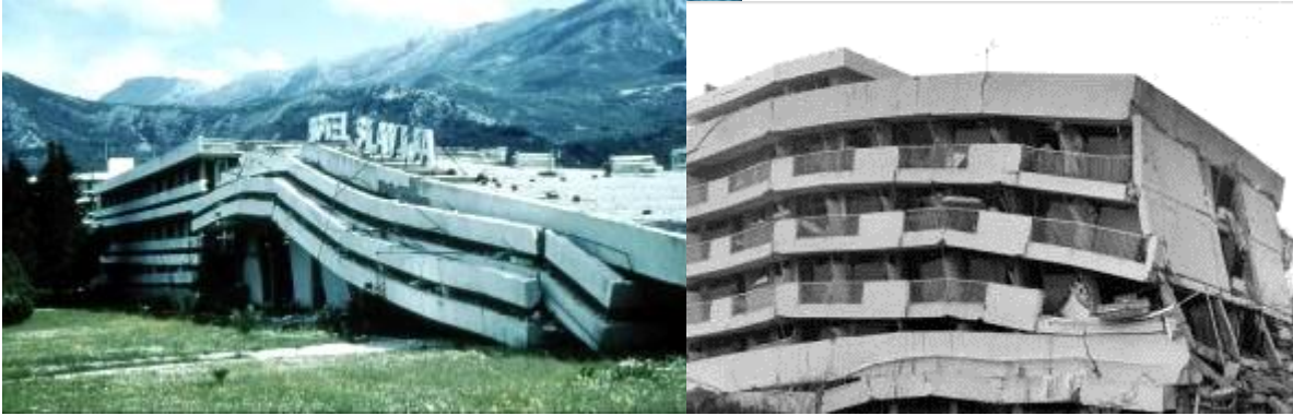
Primjeri razaranja hotelskih kapaciteta (hotel Slavija u Budvi – lijevo i hotel Agava u Baru – desno) u zemljotresu od 15. aprila 1979. godine.
