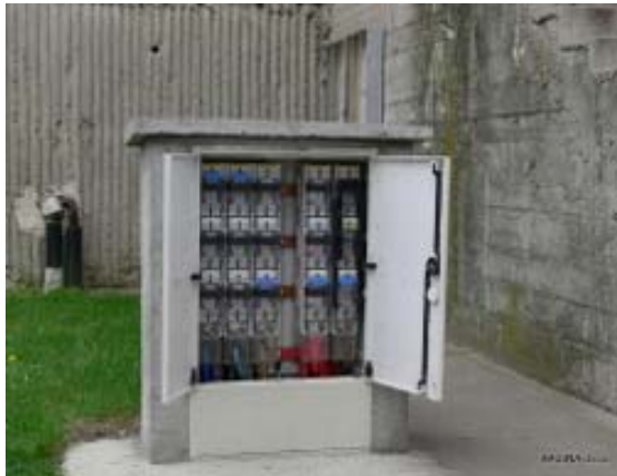
SI. Izgled niskonaponskog razvodnog ormara sa 6 izvoda »NKRO6«
