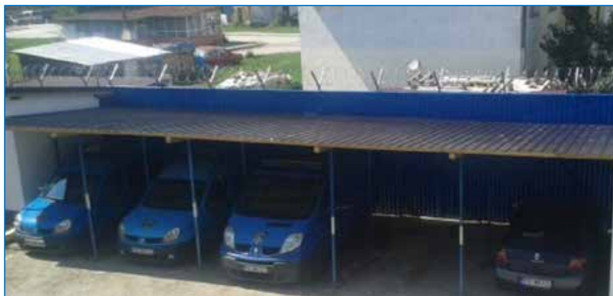
Slika br.48-U cjelosti rekonstruisane garaže za službena vozila, obnovljena krovna konstrukcija površine 110m 2
