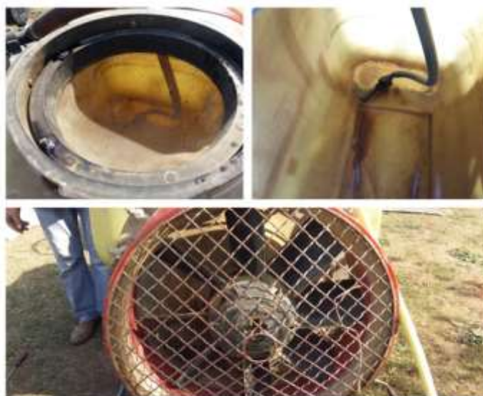
Slika 6. Zadovoljavajuće stanje rezervoara i postojanje zaštitne mreže za ventilator
