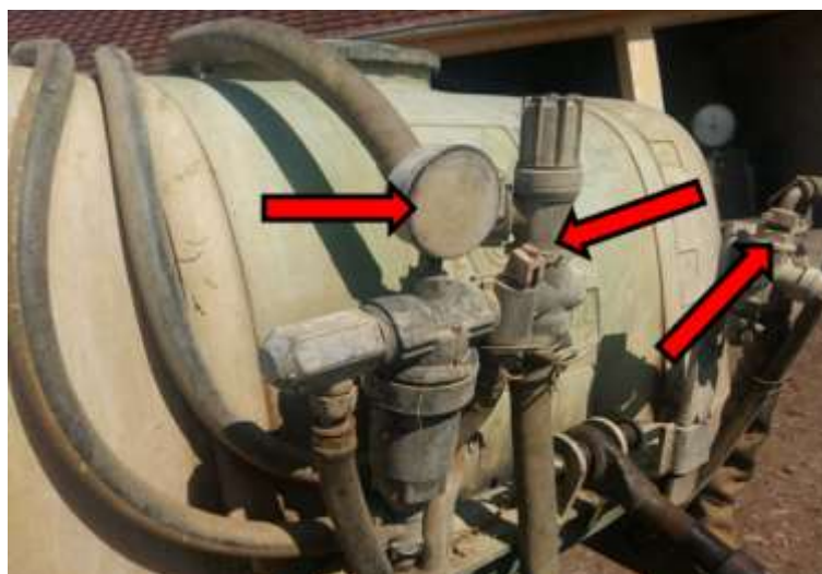
Slika 3. Nezadovoljavajuće stanje manometra i ručica ventila i razvodnika
