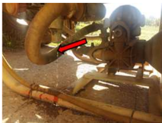
Slika 4. Gubitak vode na otvoru za otpust viška vode
