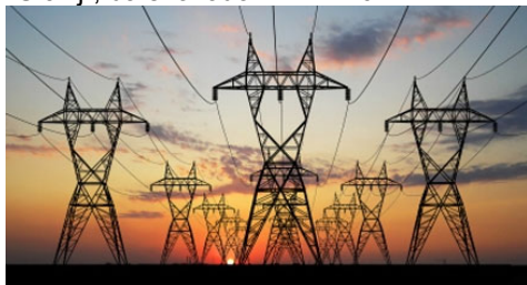
Slika: Dalekovod 110 kV
