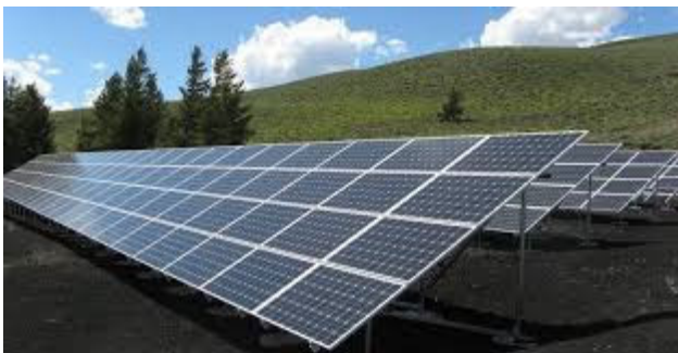
Slika: Fotonaponski paneli
