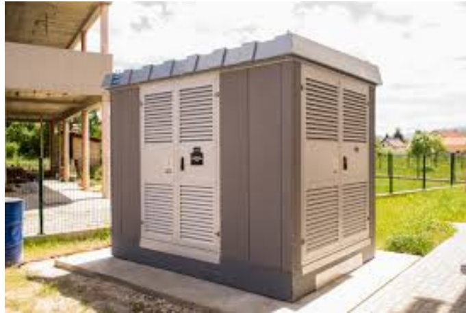
Slika. Izgled kompaktne TS 10/0,4 kV
