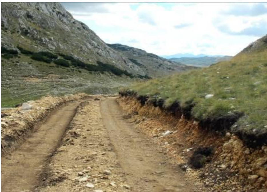
Primjer erozije uzrokovane izgradnjom puta na strmim terenima
