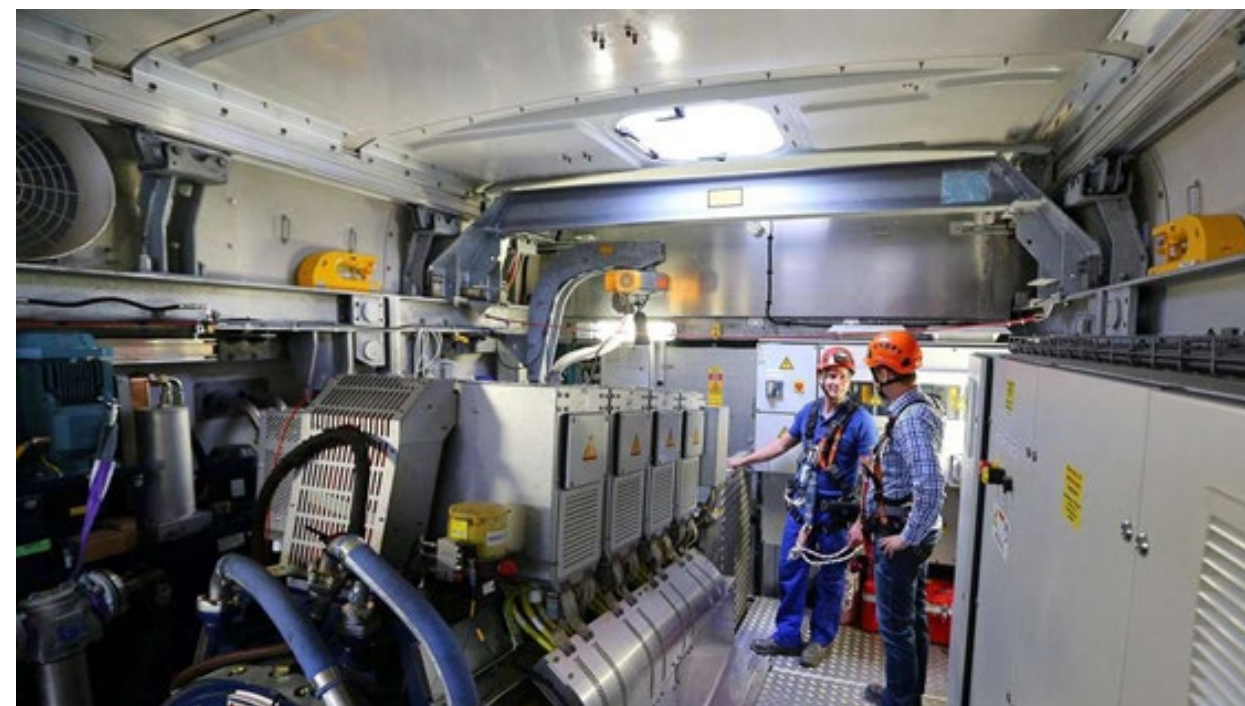
Unutrašnjost gondole vjetroturbine
