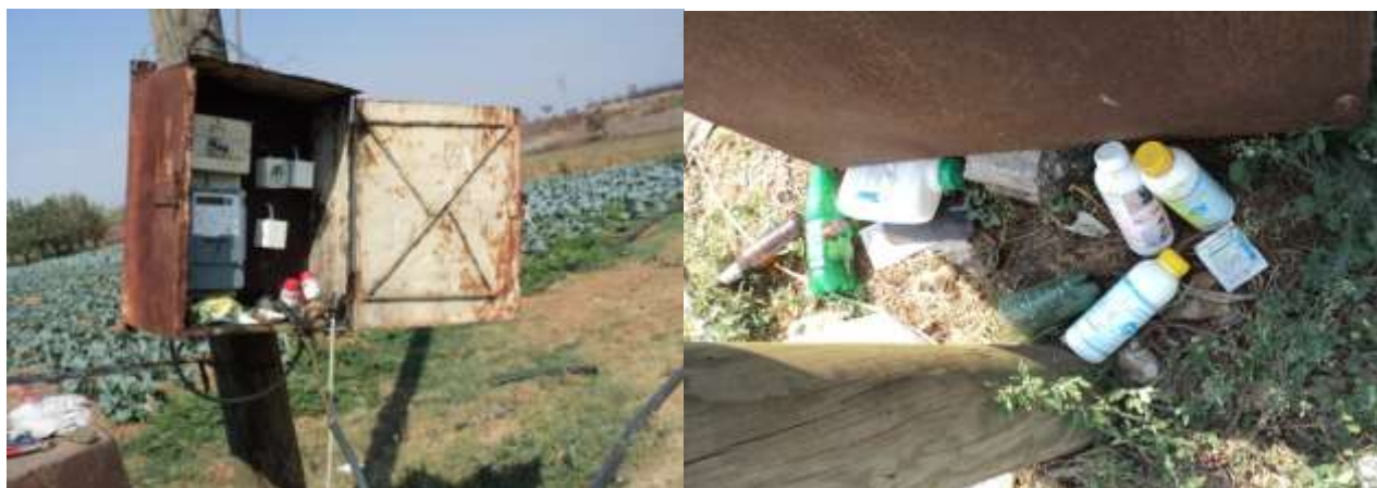
Slika 26- Nepravilno čuvanje i odlaganje preparata za zaštitu bilja
