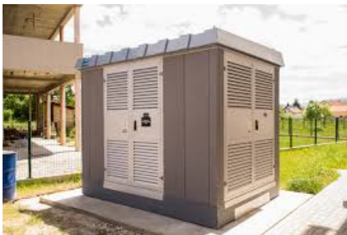
Slika. Izgled kompaktne TS 10/0,4 kV
