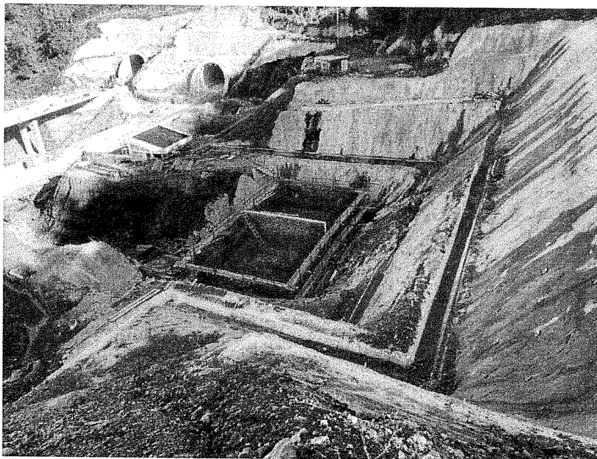
Slika br.12 - Rezervoar za vodu Podovi
