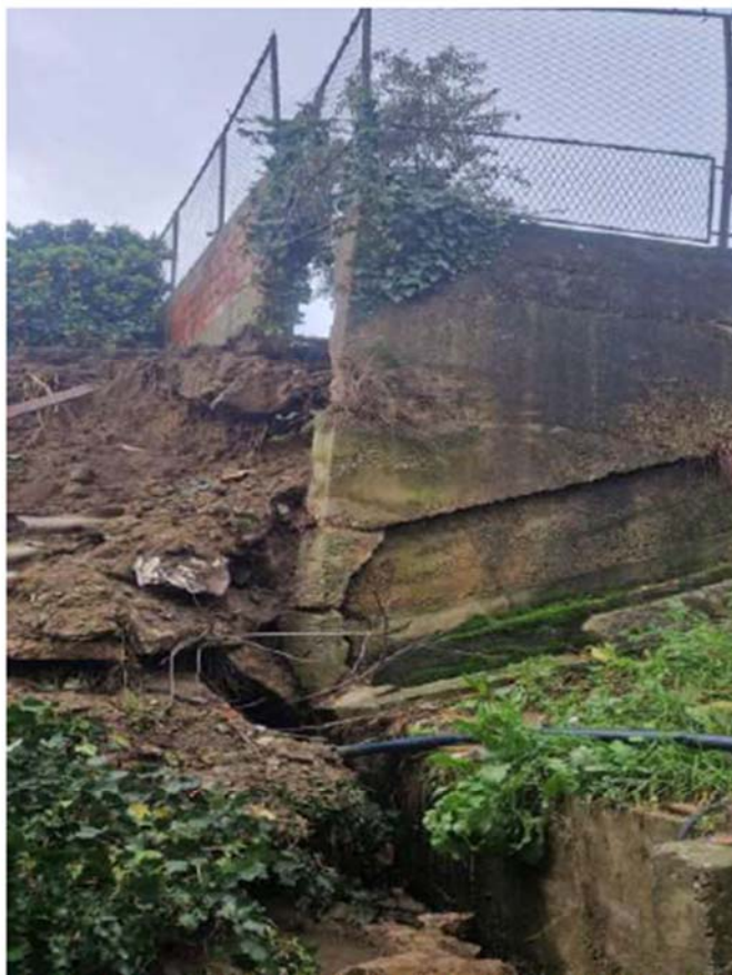
Slika 5. Dio zida u fazi značajnih pomjeranja i oštećenja prema parceli 1298
