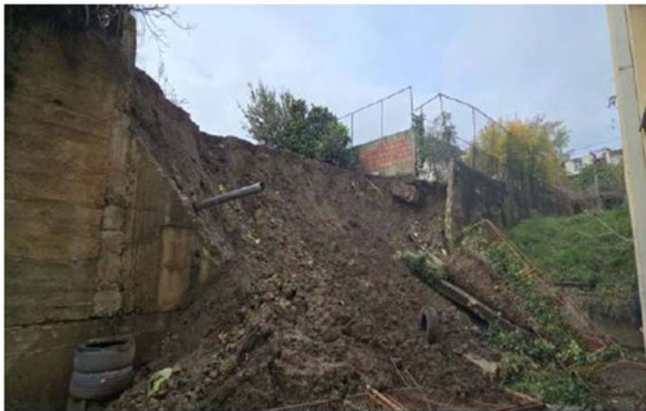
Slika 4. Obrušena potporna konstrukcija i teren
