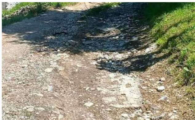
Fotografija 4. Neravnine na pristupnom putu
