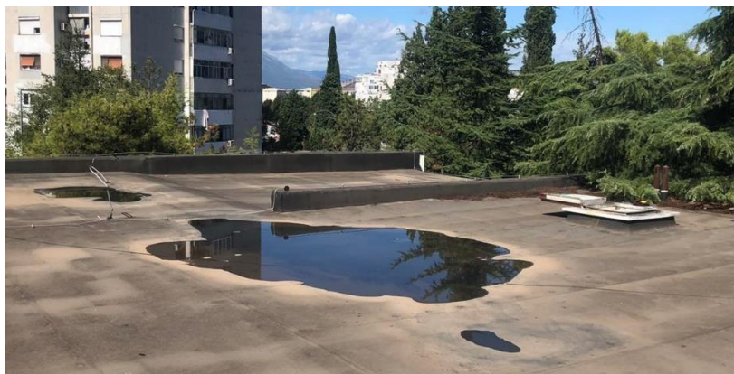
Mjesto na jednom krovu gdje se zadržala voda zbog loše odvodnje i mjesto horizontalnog oluka 3
