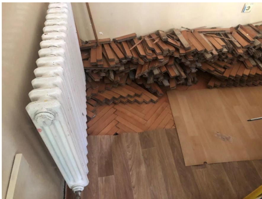
Učionica u kojoj je oštećen parket od vlage
