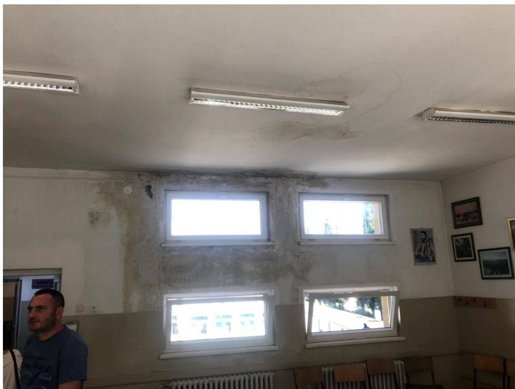
Vlaga na zidu ispod horizontalnih oluka i na plafonu od krova
