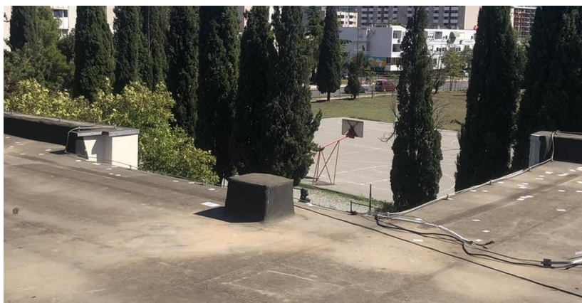
Mjesta horizontalnih oluka 1 i 2 u koje dotiče voda sa krovne površine
