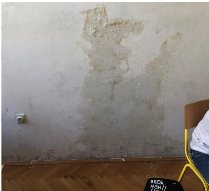
Vlaga u podnožju zida u učionici 4 Paviljona 1
