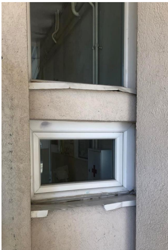
Oštećenja na solbancima PVC stolarije
