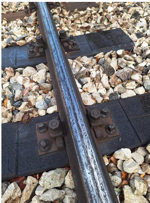
Slika 23. Izgled šina nakon proklizavanja lokomotive
