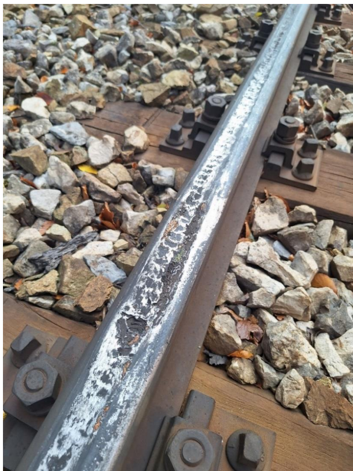
Slika 24. Izgled šina nakon proklizavanja lokomotive
