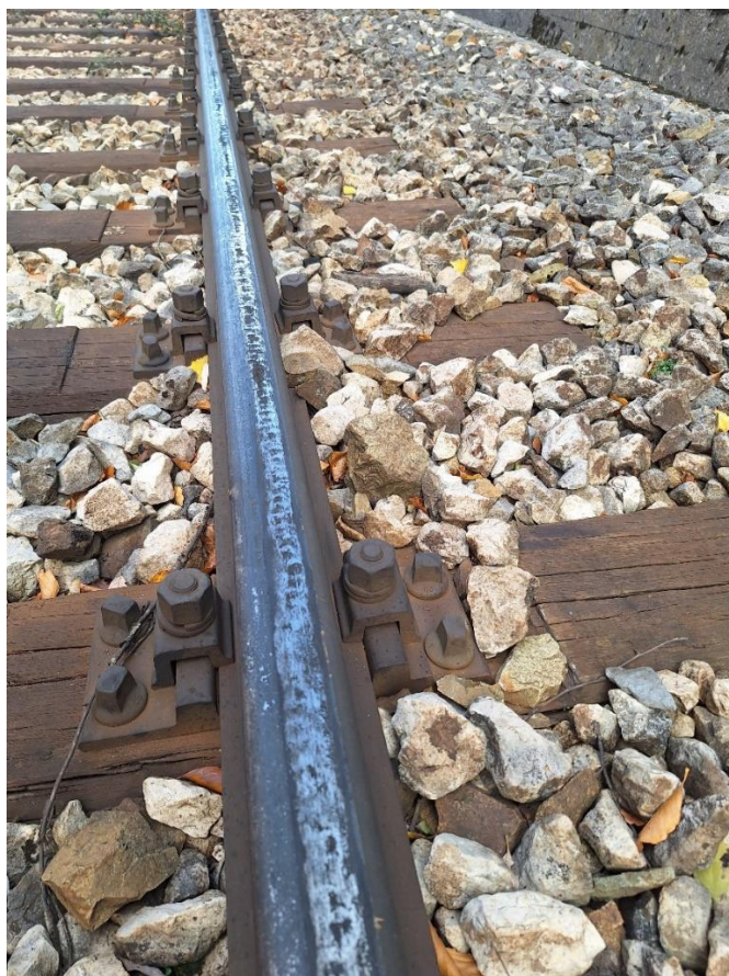
Slika 25. Izgled šina nakon proklizavanja lokomotive
