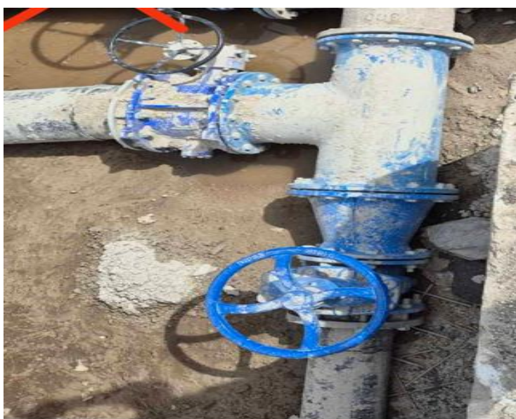
Slika br.16 Postojeći zonski šaht DMA 2
