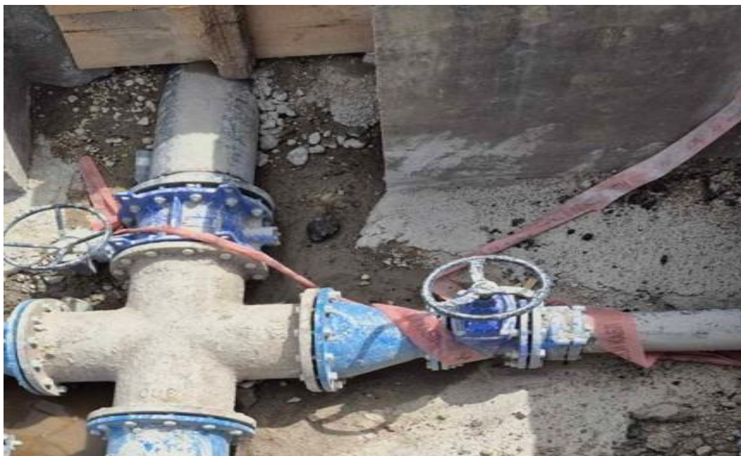
Slika br.15 Postojeći zonski šaht DMA 1
