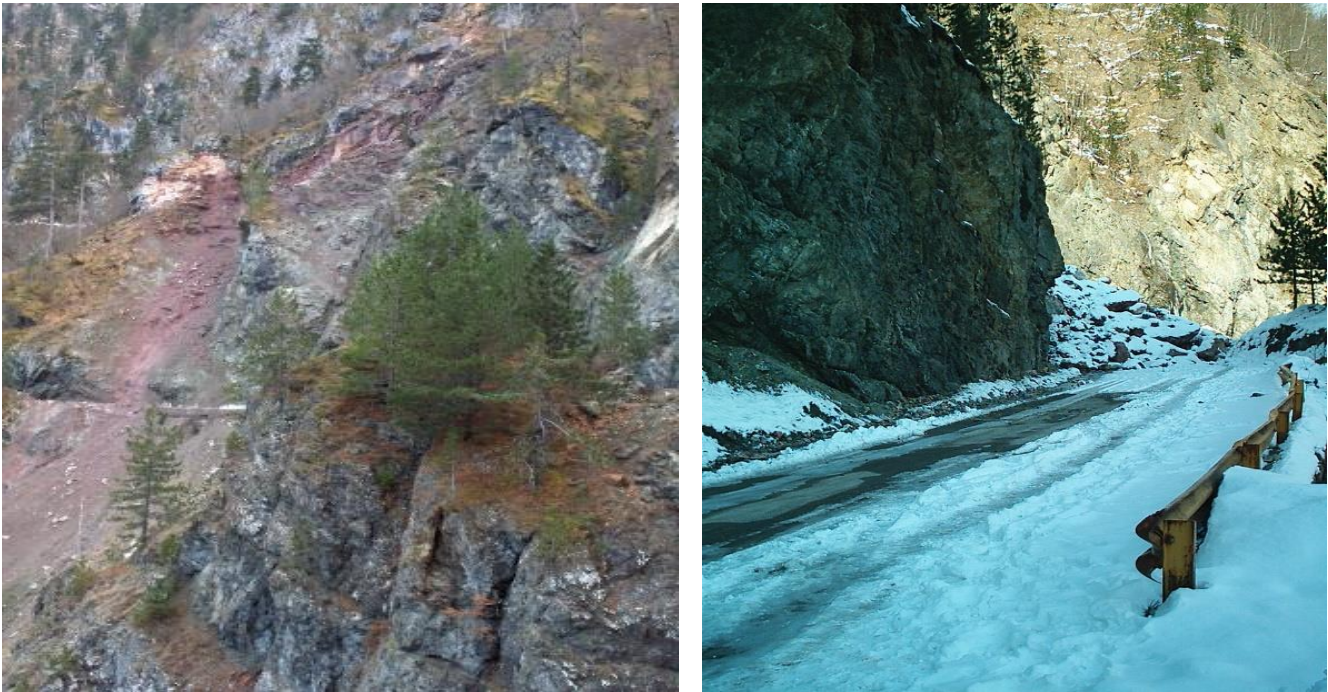
Slika 14: Odron na lokaciji Sokolovina na putu Mojkovac-Đurđevića Tara
