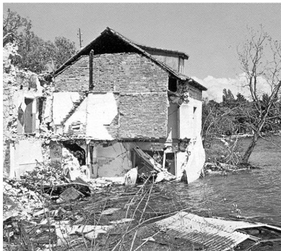
Slika 1.20-4 Zarušena zidana kuća u Kumboru, locirana na samoj morskoj obali. Zanimljiv slučaj ponašanja prethodno rekonstruisanog objekta, uz propratni efekat njegovog tonjenja: osnovni dio - sa zidovima od kamena bio je srušen, dok je dograđeni dio sa zidovima od opeke, donekle, zadržao konstruktivni integritet.
