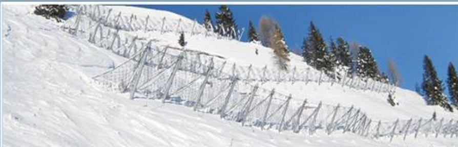
Zaštita od lavina felčnom ogradinom
