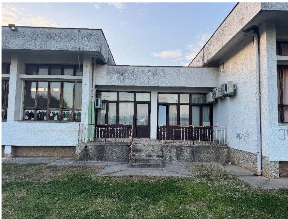
Fotografija 10 - Fasada objekta – razlika u nivoima krovnih ravni
