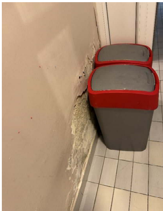
Fotografija 2- Otpadanje maltera sa zida usled vlage
