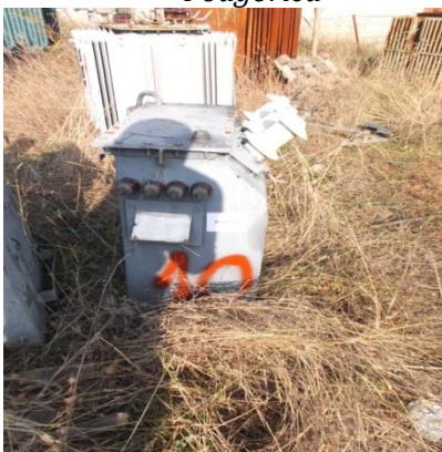
Slika 2. Mjesto uzorkovanja: Skladište rashodovanih transformatora Podgorica, 4. jul- ED Podgorica
